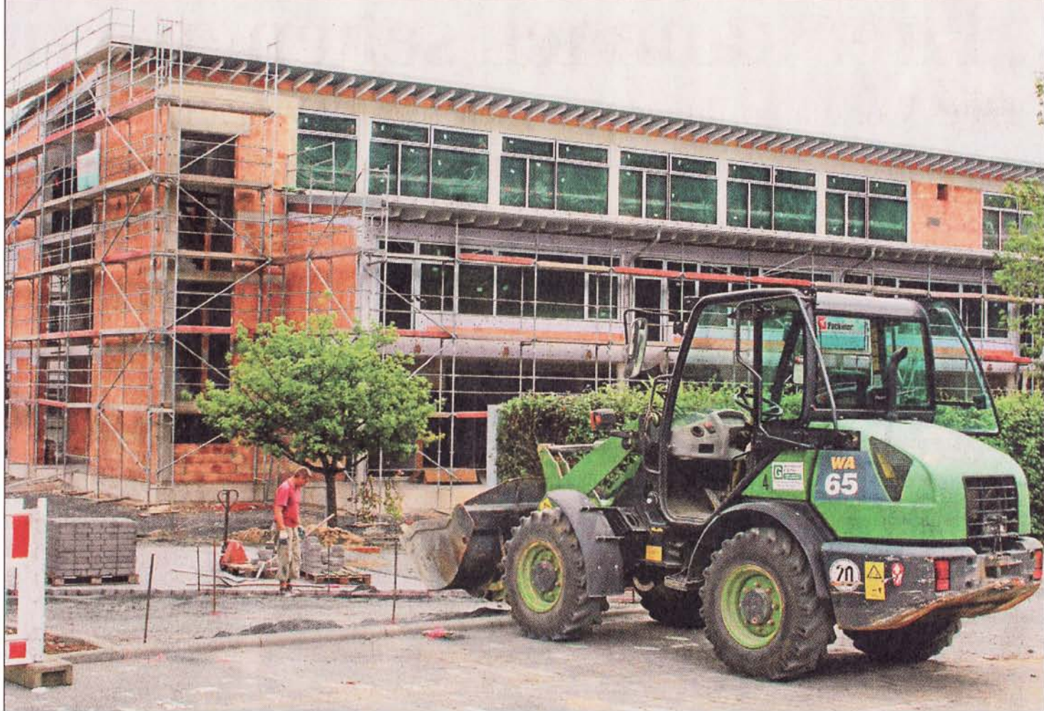
Baustelle Gymnasium: Ursprünglich hätte der Neubautrakt schon zum neuen Schuljahr fertig sein sollen, das am Montag beginnt. Der lange Winter und Altlasten im Boden haben die Arbeiten verzögert. (Foto: Wingender)
